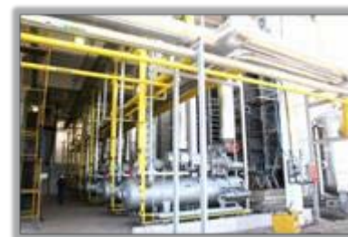
Sala de Máquinas
